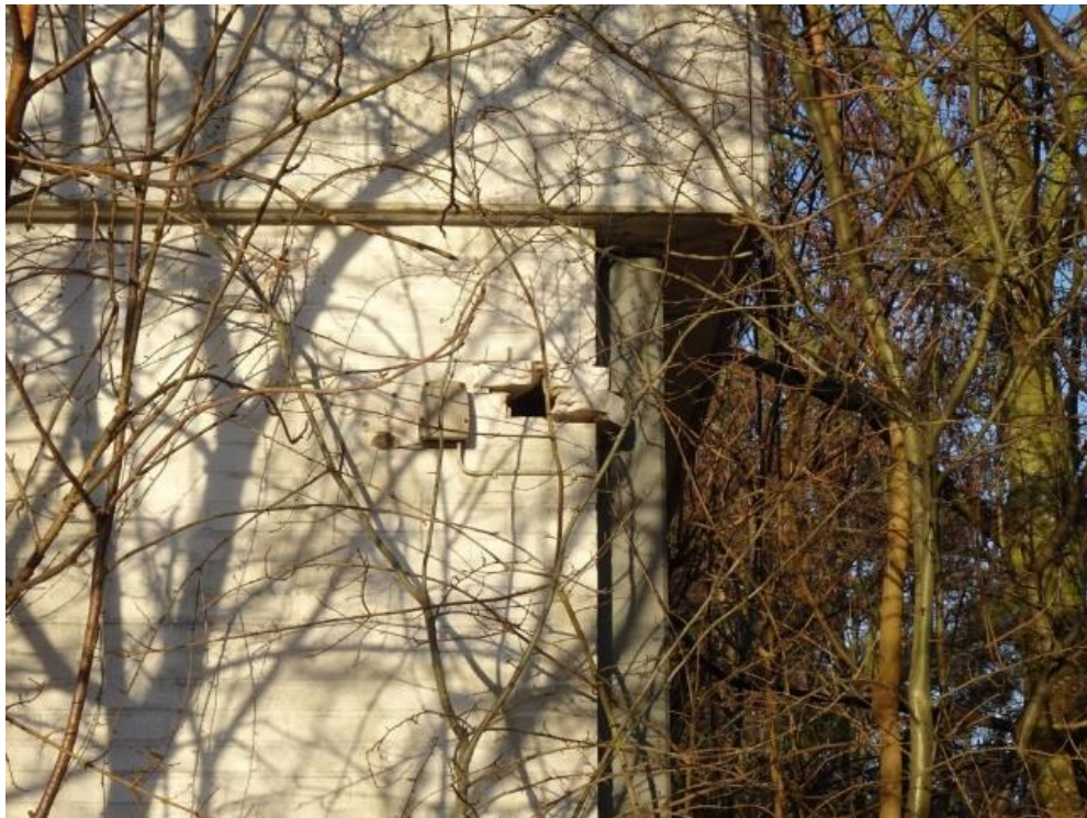
Abbildung 7: Loch in Fassade von Gebäude 4, von Vegetation umgeben
