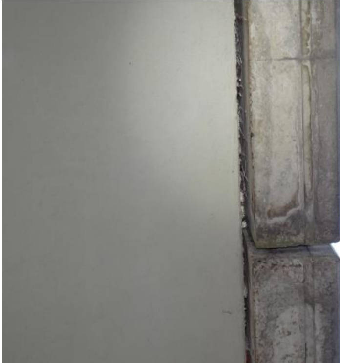
Abbildung 13: Längsfuge entlang der Auffahrtstampe. Keine Winterquartiereignung!
