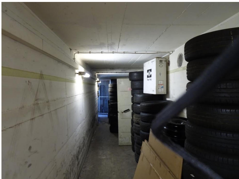
Abbildung 4: Vollverputzter Kellergang des Gebäudes 2. Im Hintergrund ist die Stahlgittertür (Eingang) zu erkennen
