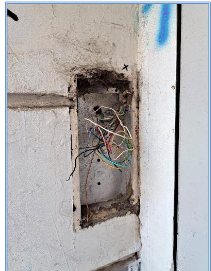
Nicht nur für Polizei und Feuerwehr problematisch: hier kann nicht mehr identifiziert werden, wer hier wohnt
